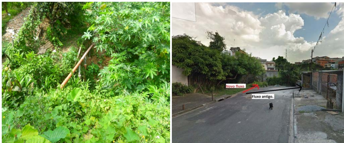
Figura 6: Rede atravessando por cima do fundo de vale para desviar o fluxo com defeito e substituir projeto MND
